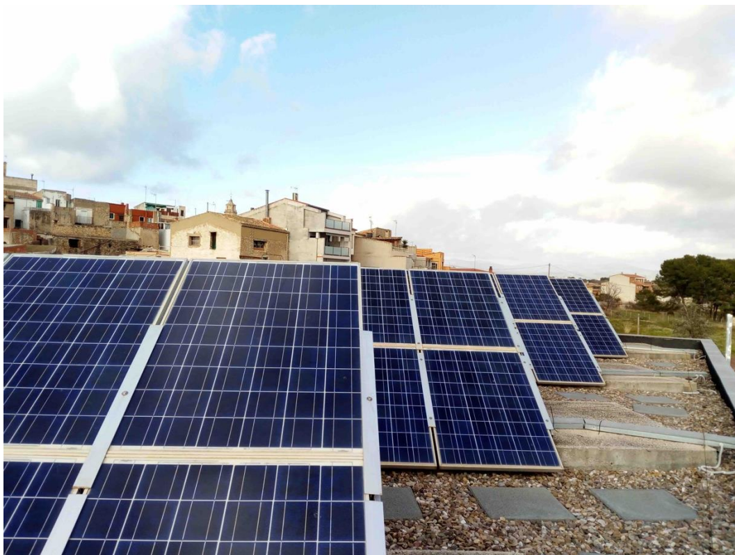
Imatge 12 - Projecte fotovoltaic en el sostre d'un edifici.
